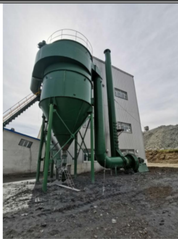
筛分车间布袋除尘器
