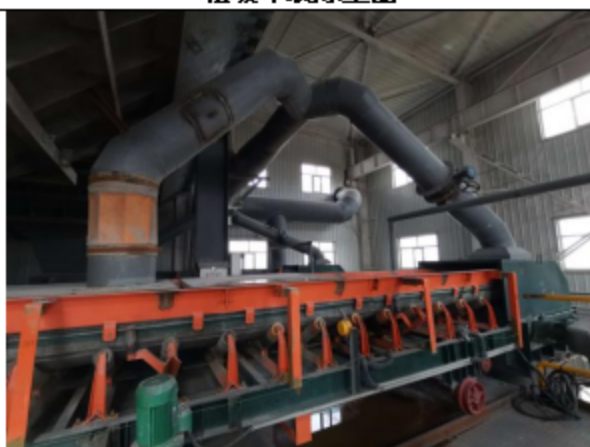
中细碎车间集尘管道
